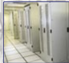
Internet Data Center
